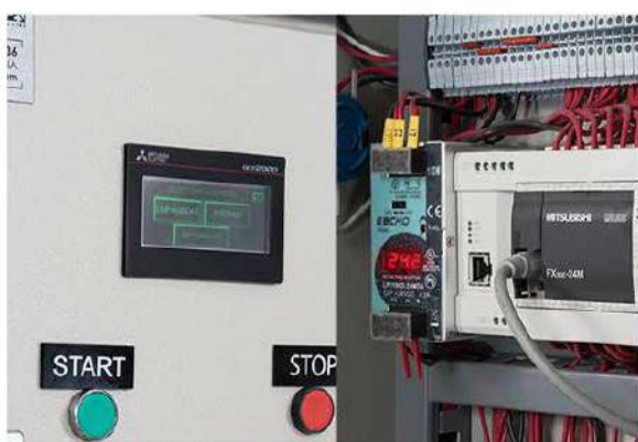
PLC FX3 CON PANTALLA HMI GT200
